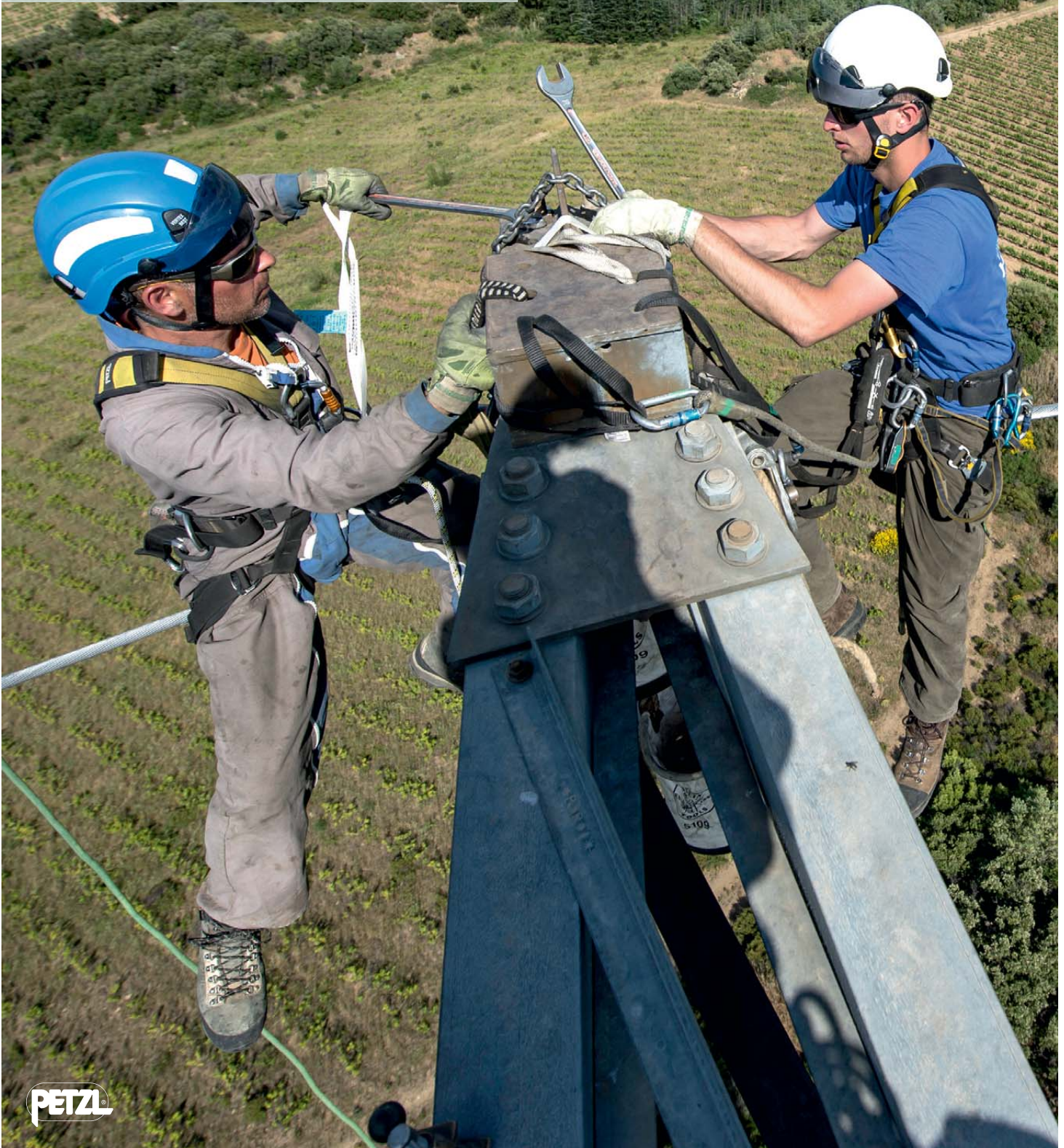
EEE-OMEXOM, ligne à 2 x 400 kV Baixas - Gaudière. La Tour de France Pyrénées Orientales, France © Sam Blé / Lafouche
